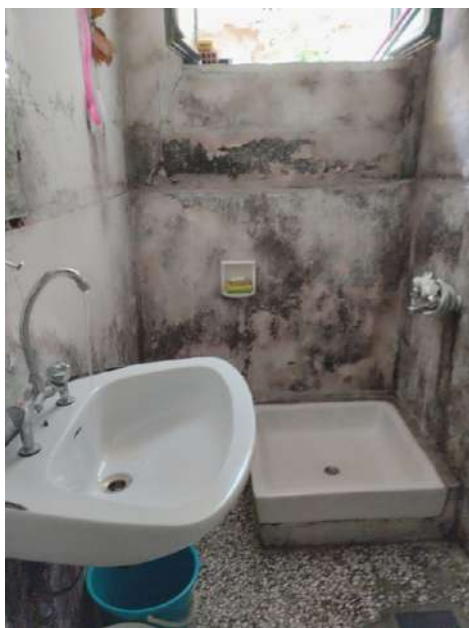
Εικόνα 9 Μπάνιο με έντονα σημάδια υγρασίας και μούχλας, σημαντικές φθορές και συνθήκες που δυσχεραίνουν τη διατήρηση επαρκούς υγιεινής
